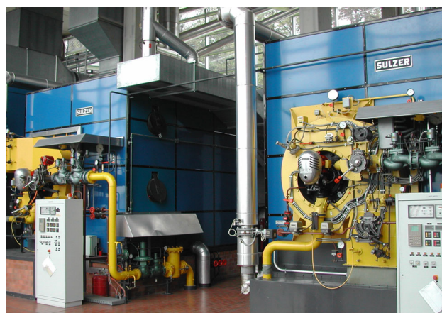
Kessel-Anlage der ETH Hönggerberg
