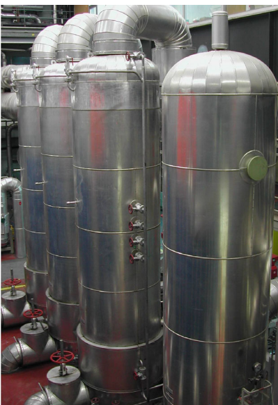
Dampf-Umformer der ETH Zentrum
